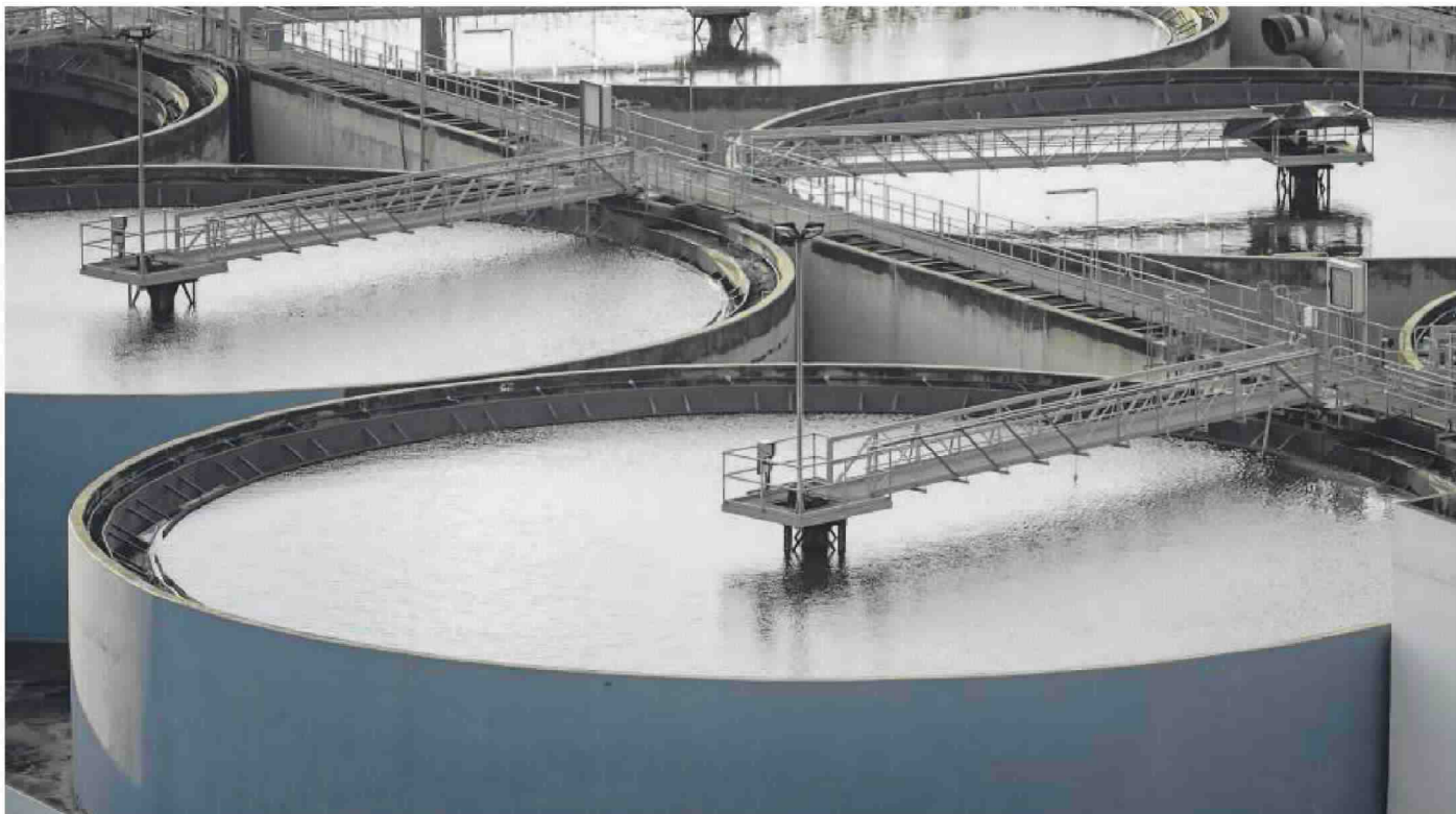
LA TECNOLOGIA DELL'AZIENDA SI INSERISCE LADDOVE LE UTILITY COMUNALI OGGI GESTISCONO I DEPURATORI
